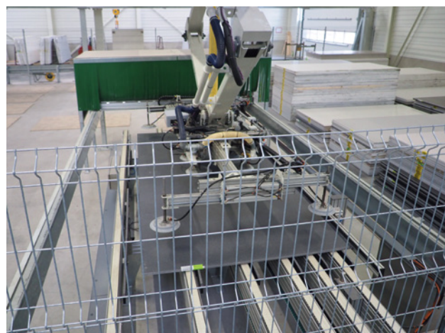
Mit einem Vakuumflifter werden die Platten aus dem Flächenlager auf einer Riemenförderstrecke mit Zentrierung und pneumatischen Aushüben abgelegt, jedes Werkstück bekommt einen Barcode
